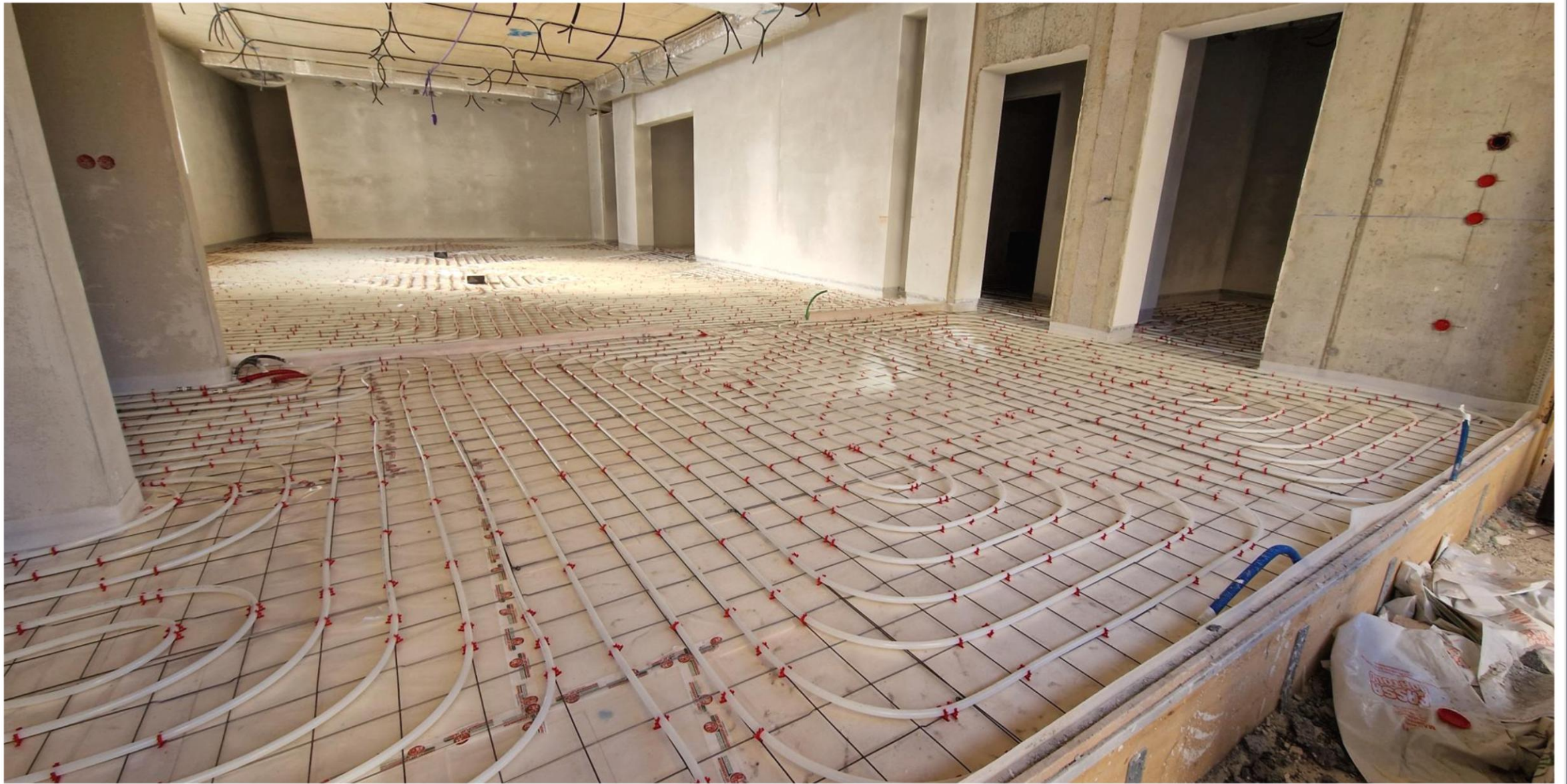
Fußbodenheizung im Saal im November 2024
